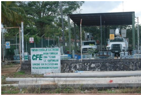
Subestación y oficinas de la CFE
